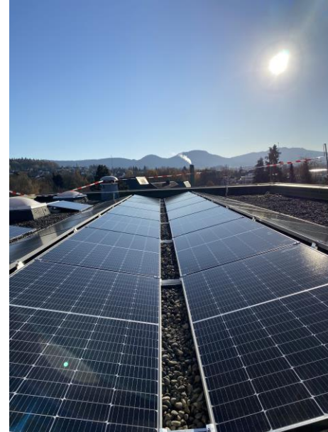
PV-Anlage LRA Zollernalbkreis
